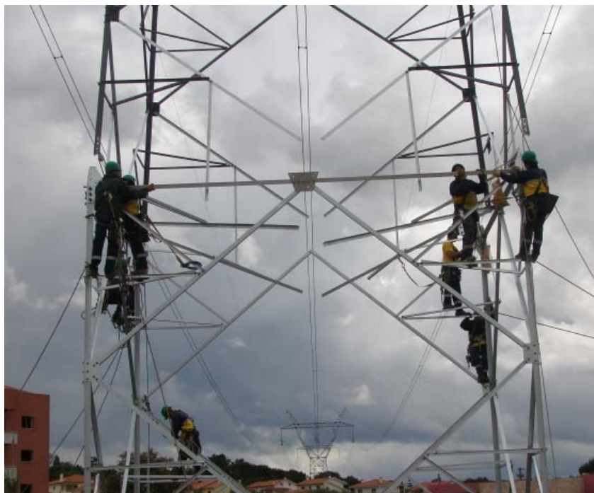
Figura 2.4 Montagem de módulo prismático em apoio de suspensão (fonte: REN).
