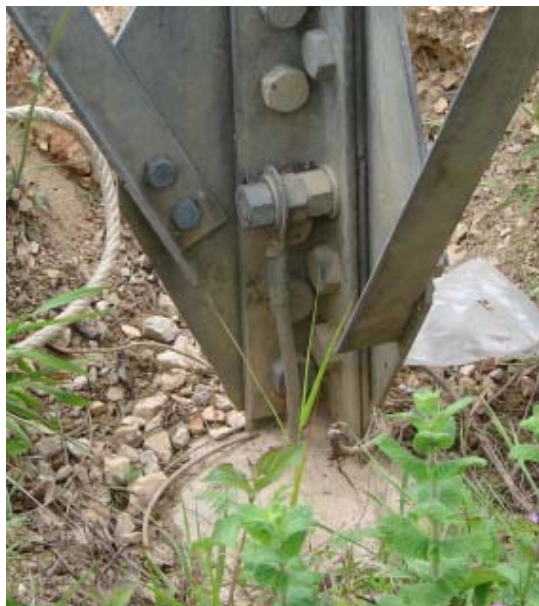
Figura 2.6 Pormenor de ligação à terra de um apoio (fonte: REN).
