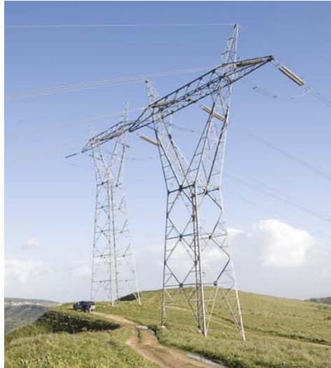
Figura 2.2 Apoios de linha em esteira horizontal, de amarração (fonte: REN).
