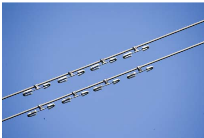
Figura 2.10 Amortecedores de vibrações em cabos condutores – tipo “stockbridge” (fonte: REN)
