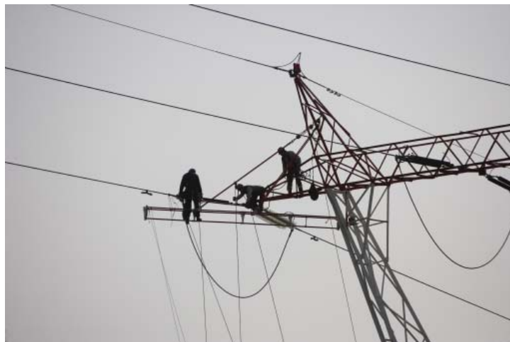
Figura 5.3 Substituição de isoladores de vidro por compósitos (fonte: REN).
