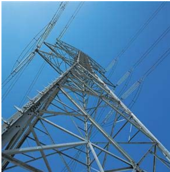
Figura 2.3 Poste linha dupla em esteira vertical, de amarração (fonte: www.ree.es ).
