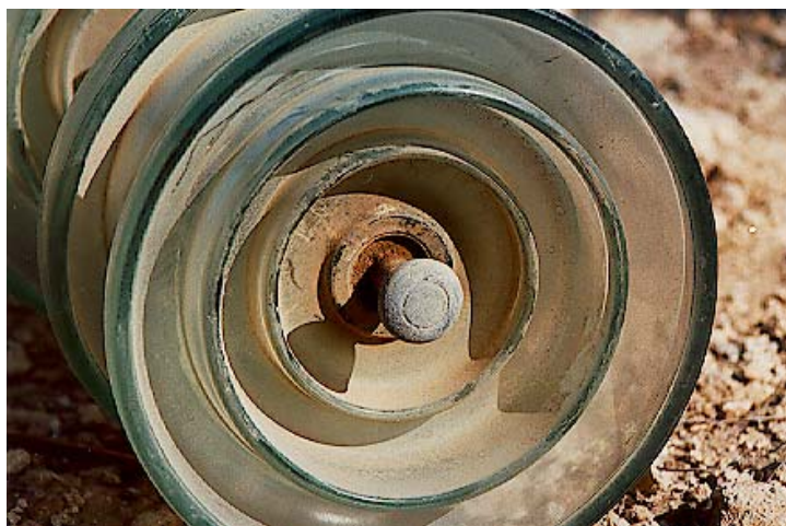
Figura 5.1 Isolador de vidro afectado por poluição salina muito forte.
