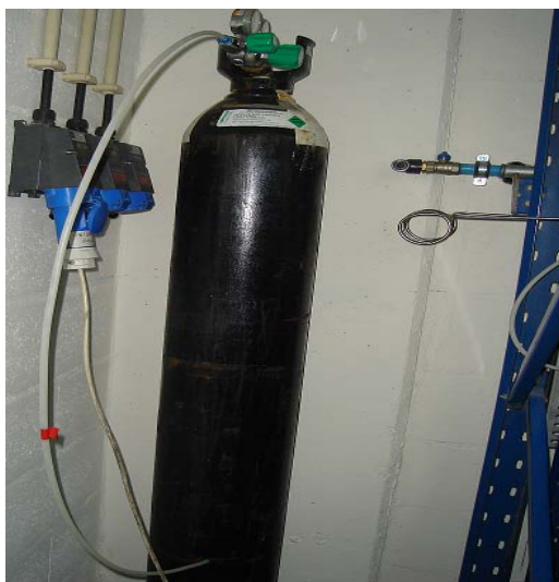
Figura 41 Imagem da garrafa que fornece o ar comprimida á instalação
