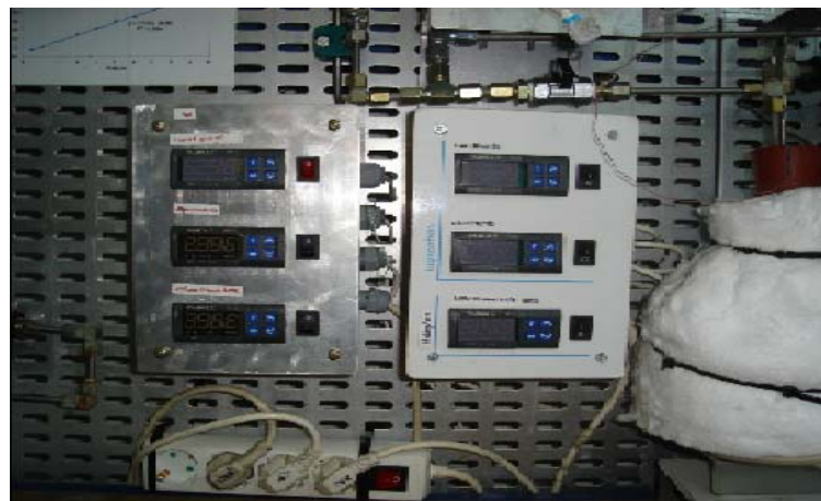
Figura 47 Controladores de temperatura, pressão e humidade (Ar / H 2 )
