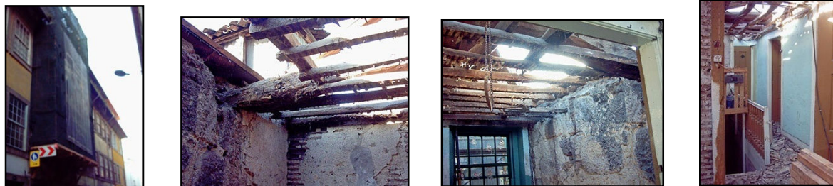
Fig. 4.11 a 4.14 – Estado de degradação física das habitações no quarteirão Carlos Alberto antes das obras (Fonte: www.porto.taf.net/dp/node/3512 , consultado em Abril 2008)
