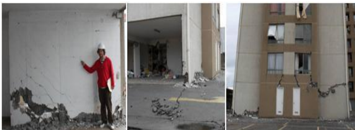
Figura 2. 18 – Rotura de parede no piso inferior de um edifício por corte [6]
