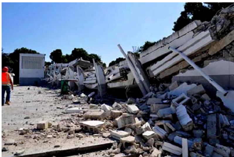
Figura 2. 8 – Edifício escolar de 2 pisos em Leogane – colapso total [2]
