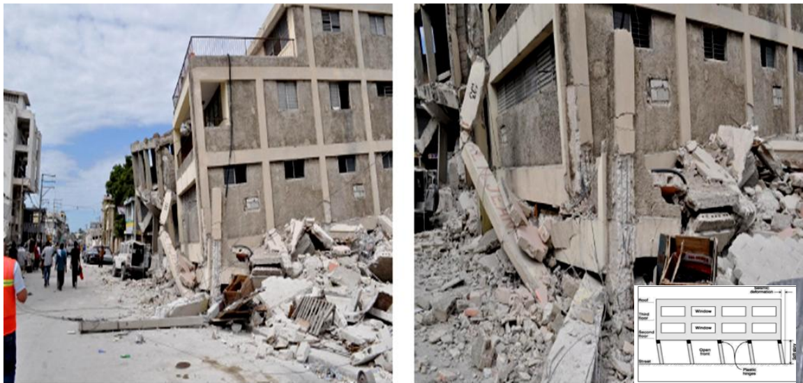
Figura 2. 9 - Primeiro piso em colapso devido a falta de resistência das paredes [2]
