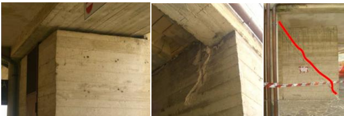
Figura 2. 17 – Rotura por corte de parede estrutural em L'Àquila [10]
