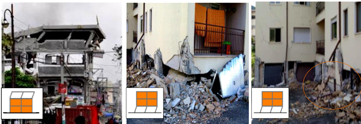
Figura 2. 13 – Soft storey em piso superior [53]; soft storey em primeiro piso em L'Aquila [10]
