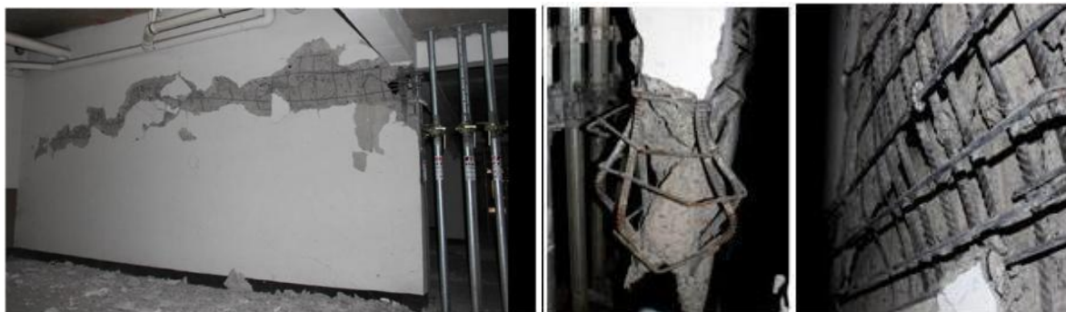
Figura 2. 16 – Rotura de parede estrutural [6]
