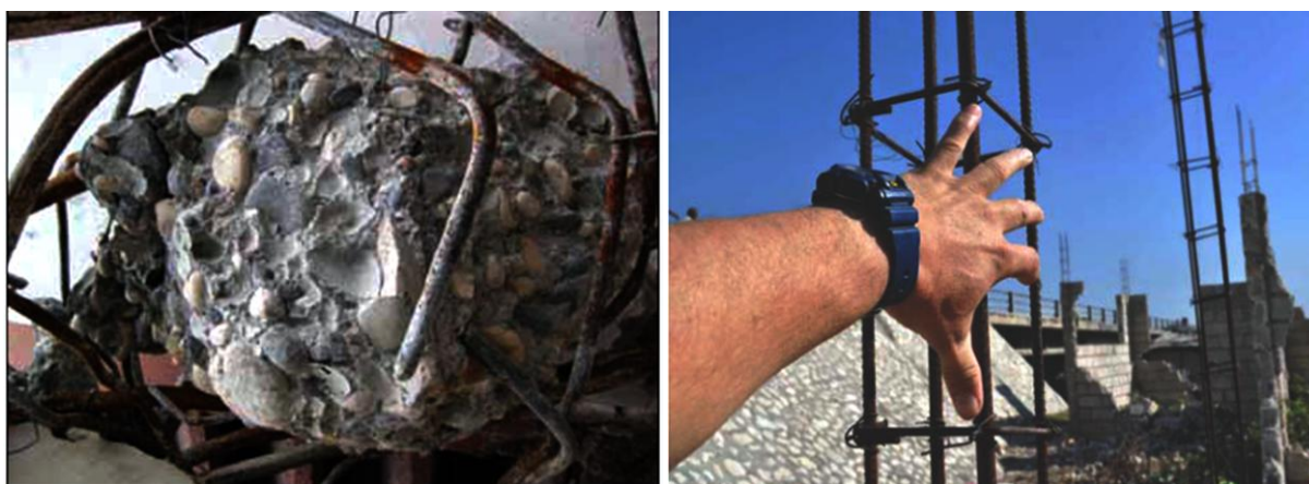
Figura 2. 14 – Falta de ligante e pormenorização das armaduras [3] e elevado espaçamento entre estribos [2]
