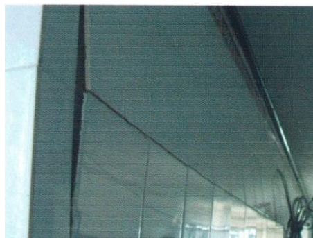
Figura 3.2 – Empolamento acentuado em revestimentos interiores [7]
