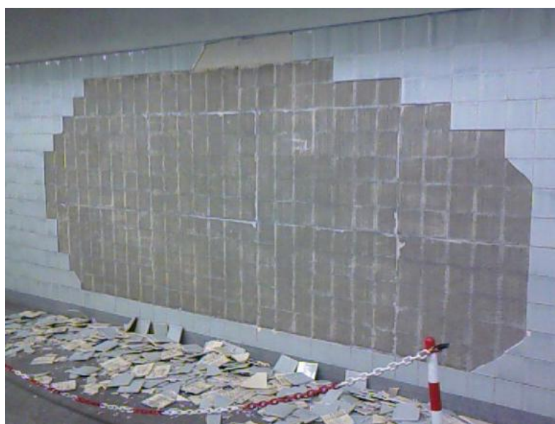
Figura 4.3 – Descolamento pontual (extenso)
