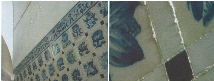
Figura 3.12 – Refluxo de sais pelas juntas de azulejo em edifício antigo, devido a humidades ascensionais do terreno [7]
