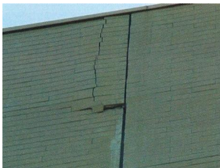
Figura 3.5 – Junta de dilatação estrutural com funcionamento não eficaz para o revestimento [7]
