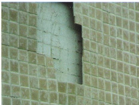
Figura 3.3 – Descolamento, empolamento e queda por acção da água infiltrada para o tardo [7]
