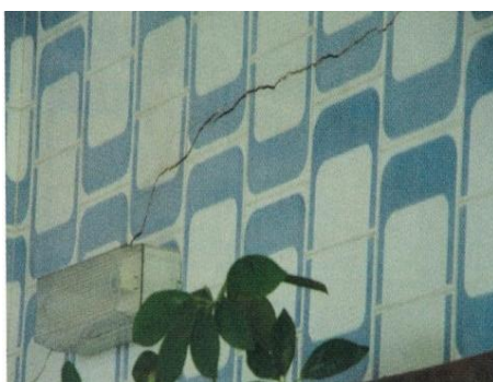
Figura 3.4 – Fissura trespassante sem descolamento do azulejo, evidenciando a qualidade da colagem e a sua baixa resistência [7]
