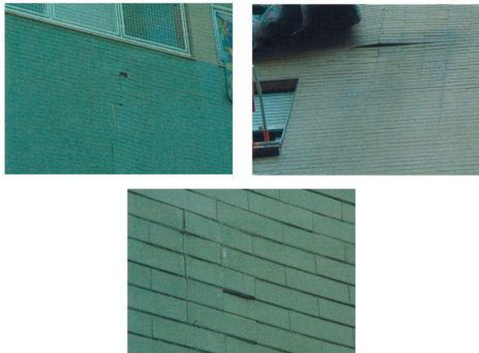
Figura 3.6 – Fissuração e empolamento em panos de grande dimensão sem juntas de esquadramento [7]
