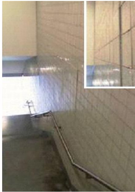
Figura 4.5 – Azulejos descolados e em risco de queda
