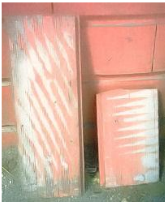
Figura 5.18 – Tardoz de ladrilhos, evidenciando assentamento deficiente dos ladrilhos [30]
