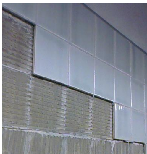
Figura 4.4 – Queda generalizada de azulejos
