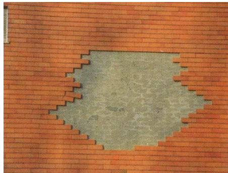
Figura 3.1 – Descolamentos pontuais mas extensos, sem empolamento aparente, recomendando inspeção geral das condições de aderência [7]
