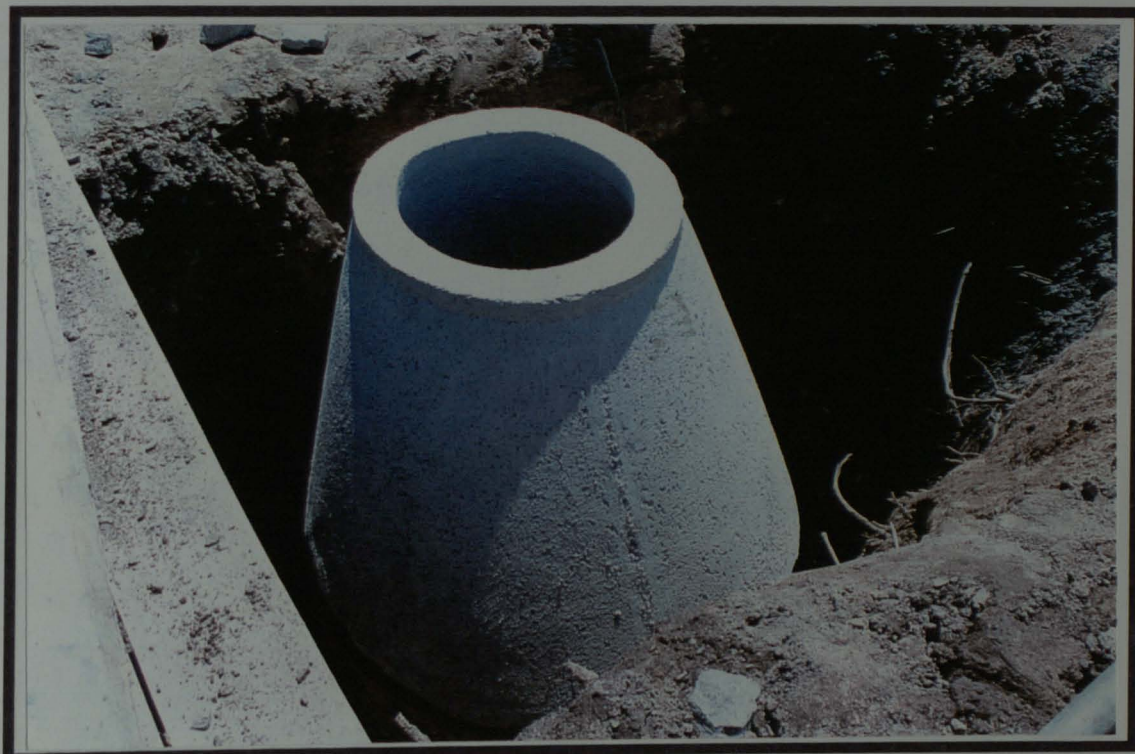
Figura 18 – CAIXA DE VISITA
