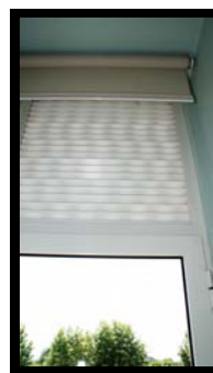
Fig.42 – Grelha de ventilação Escola EB1 da Igreja (Paços de Brandão – Santa Maria da Feira)
