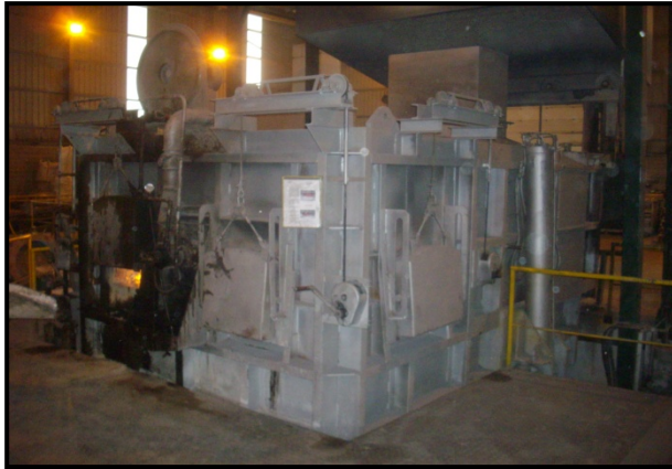
FIGURA 11 – Forno de manutenção/afinação de 10 toneladas (traseira).
