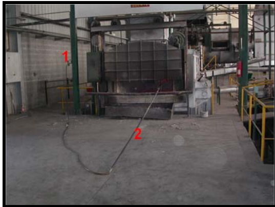
FIGURA 25 – Unidade de desgasificação.
