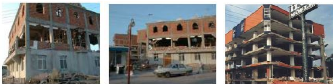
Fig.2.1 – Colapsos de paredes de alvenaria para fora do plano (Varum, 2003)
