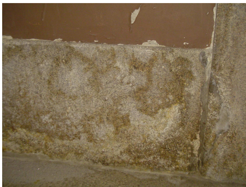
Figura 3.4 – Manchas escuras de humidade nas paredes
