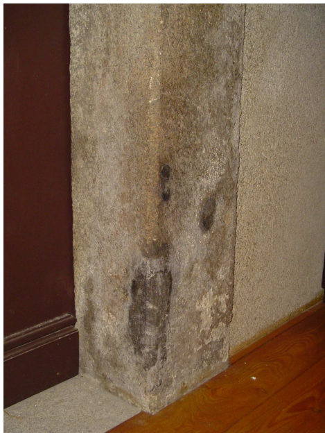
Figura 3.3 – Manchas escuras de humidade nas paredes
