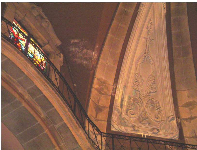
Figura 3.5 – Condensações na cobertura
