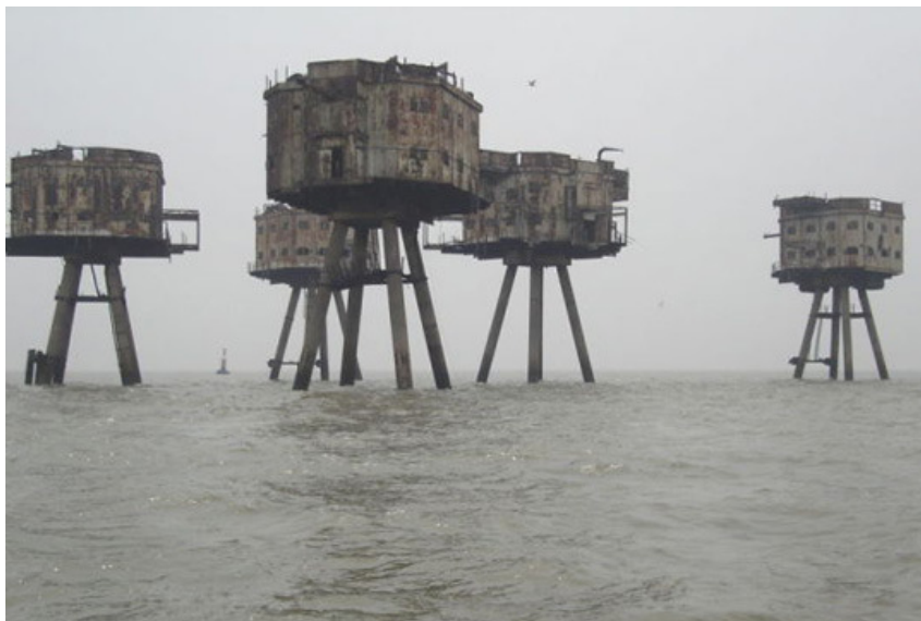
Fig. 2.13 – Exemplo de estruturas de betão corroídas pelos cloretos, retirado de Aguiar e Sousa (2009)
