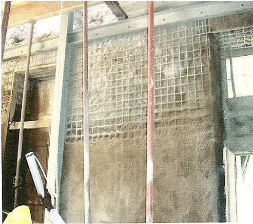
Fig.35 – Aplicação de armadura e projecção de betão para consolidação e reforço da parede de alvenaria, (Fonte [31])
