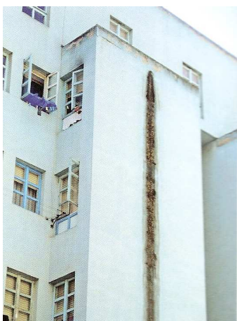
Fig.46 – Degradação de revestimento de parede por deficiente concepção do sistema de drenagem de águas pluviais, (Fonte [31])
