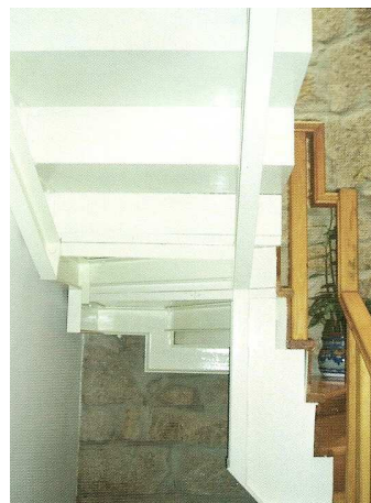
Fig.30 – Escada íngreme e sem patamar em edifício antigo, (Fonte [31])
