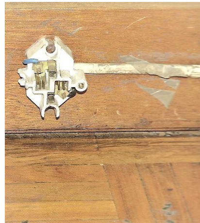
Fig.50 – Tomada externa sem tampa de protecção e com condutores em tensão acessíveis, (Fonte [31])
