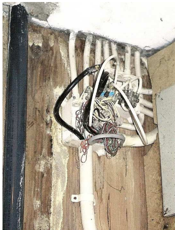
Fig.49 – Ligações de televisão inadequadas, (Fonte [31])
