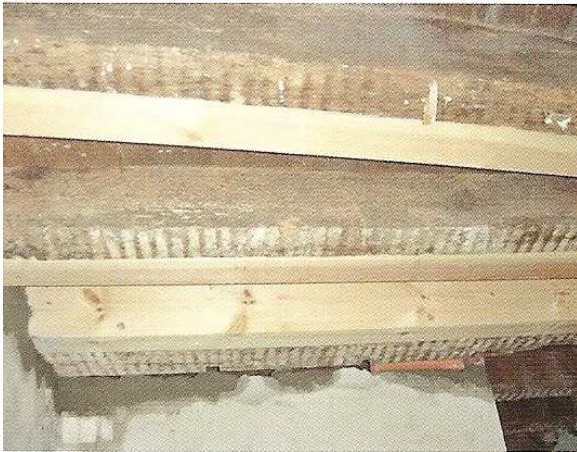
Fig.44 – Adição de vigas de madeira em pavimento para aumento da secção resistente, (Fonte [31])
