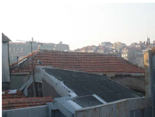
Figura 3.31 – Anomalias em dois edifícios vizinhos com coberturas inclinadas
