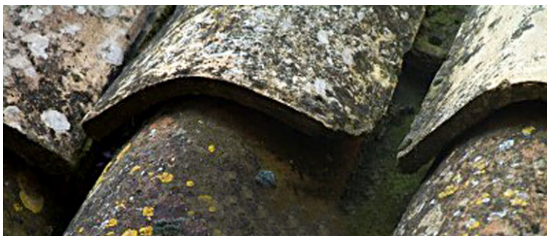
Figura 3.29 – Telhas canudo degradadas [14]
