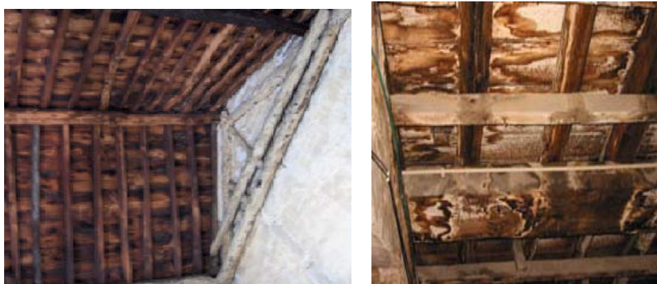
Figura 3.28 – Apodrecimento da estrutura de madeira da cobertura
