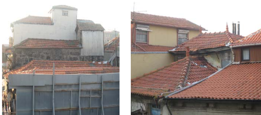
Figura 3.32 – Anomalias em telhados na zona do Centro Histórico do Porto
