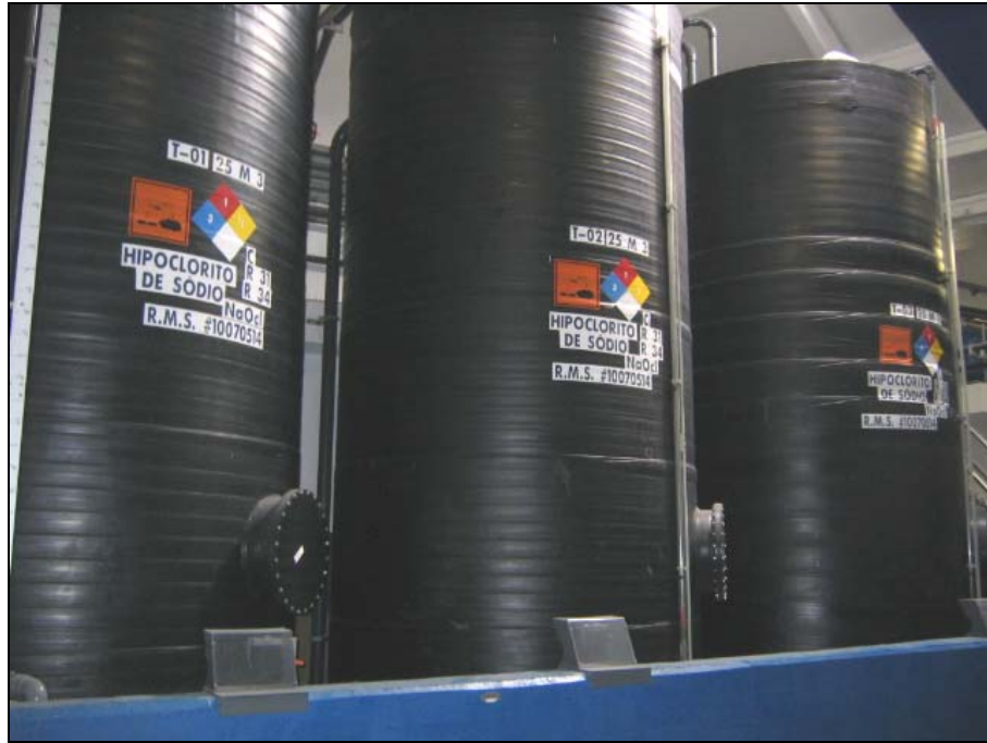
Figura 7 – Silos de Hipoclorito de Sódio na P&G
