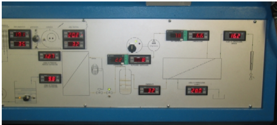
Figura 28 - Pannel com indicadores digitais de temperaturas e pressões.
