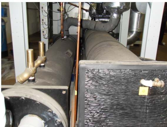
Figura 63 - Condensador e evaporador da ALFA LAVAL.
