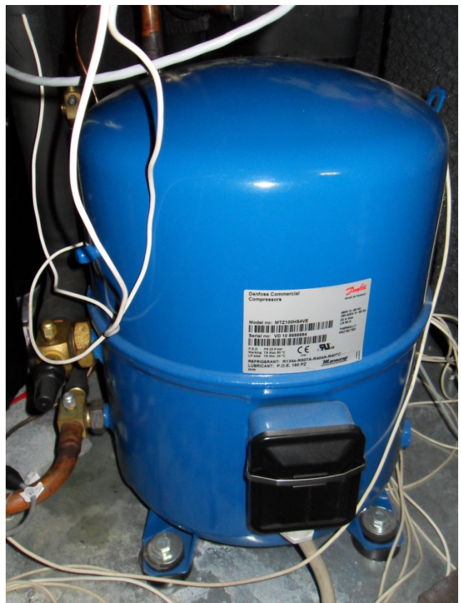
Figura 49 - Vista principal do compressor.
