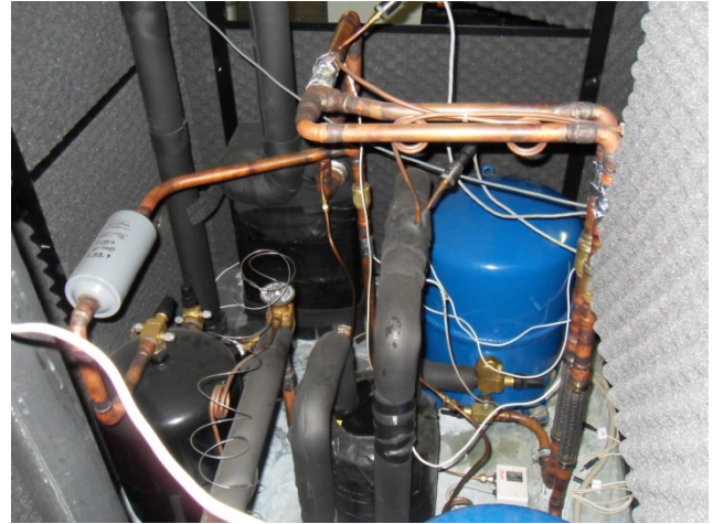
Figura 44 - Vista interior do chiller (2).
