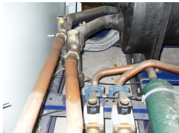
Figura 62 - Válvulas de expansão.
