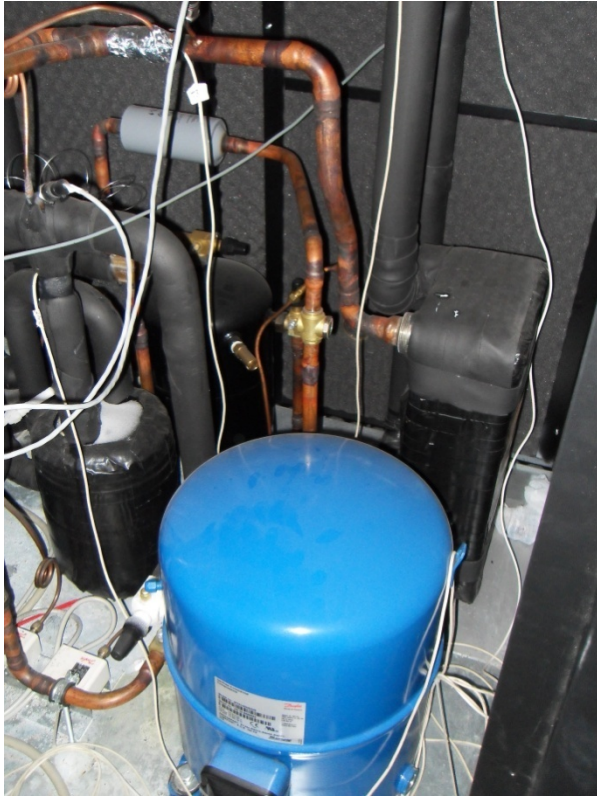
Figura 45 - Vista interior do chiller (1).
