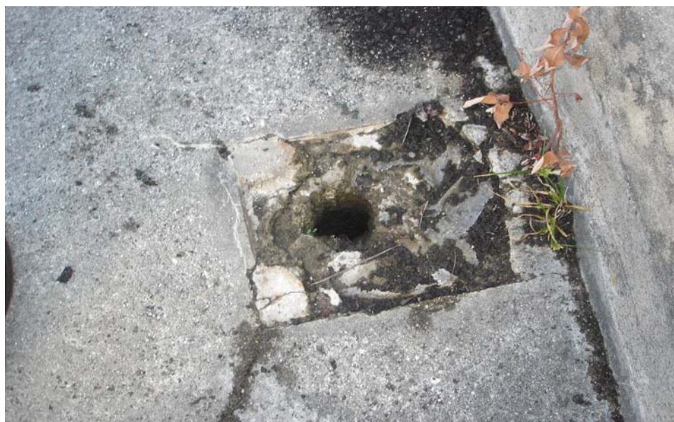
Fig. 2.3 – Má execução do escoamento de águas pluviais, nos dispositivos de recolha e evacuação de águas
