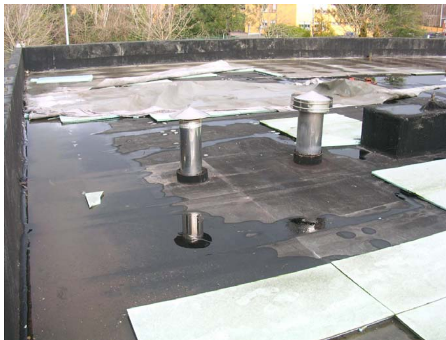
Fig. 2.1 – Cobertura plana com problemas de estanquidade na superfície corrente
