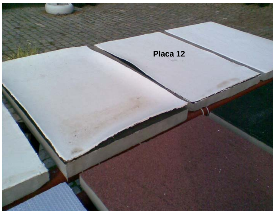
Fig. 5.33 – Pormenor do destacamento da tela betuminosa (placa 12)
