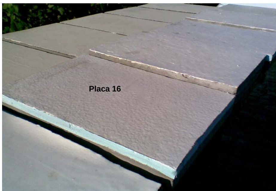
Fig. 5.34 – Pormenor referente à presença de gotas de água (placa 16)
