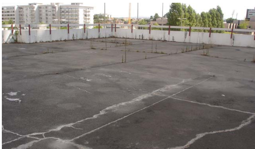
Fig. 2.2 – Cobertura plana com problemas de estanquidade na zona periférica e na superfície corrente
