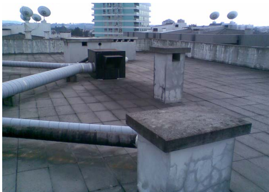
Fig. 2.4 – Infiltrações através das chaminés e das tubagens emergentes
