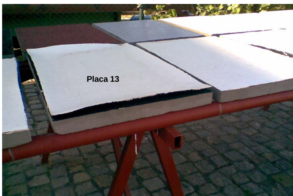
Fig. 5.32 – Pormenor do destacamento da tela betuminosa (placa 13)
