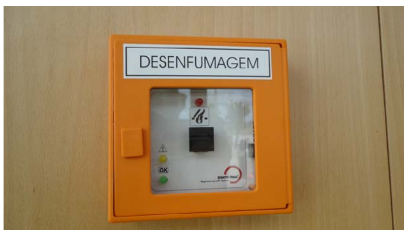
Fig. 5.27 – Botão de accionamento manual do sistema de desenfumagem
