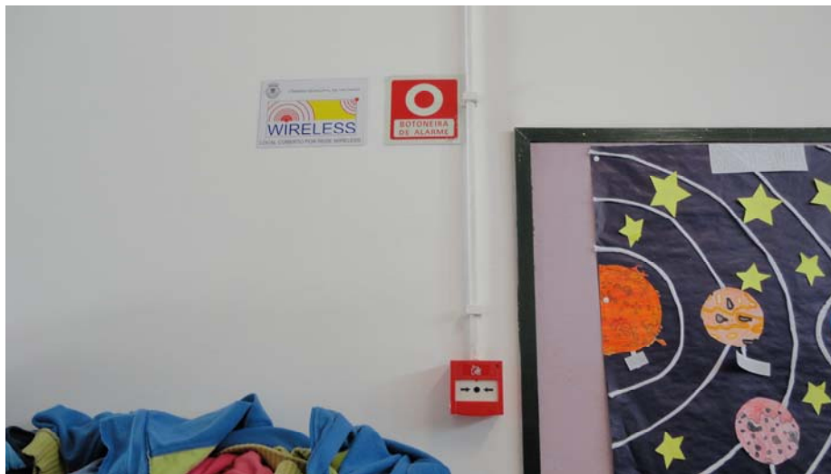
Fig. 5.22 – Botões manuais de alarme
