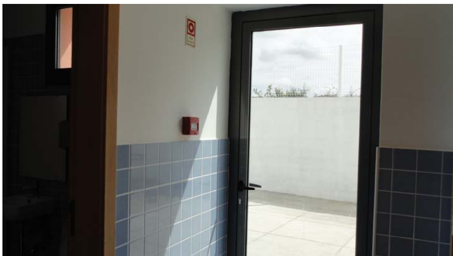
Fig. 5.26 – Botão de accionamento manual junto a uma das saídas do corpo C (com local de risco C)
