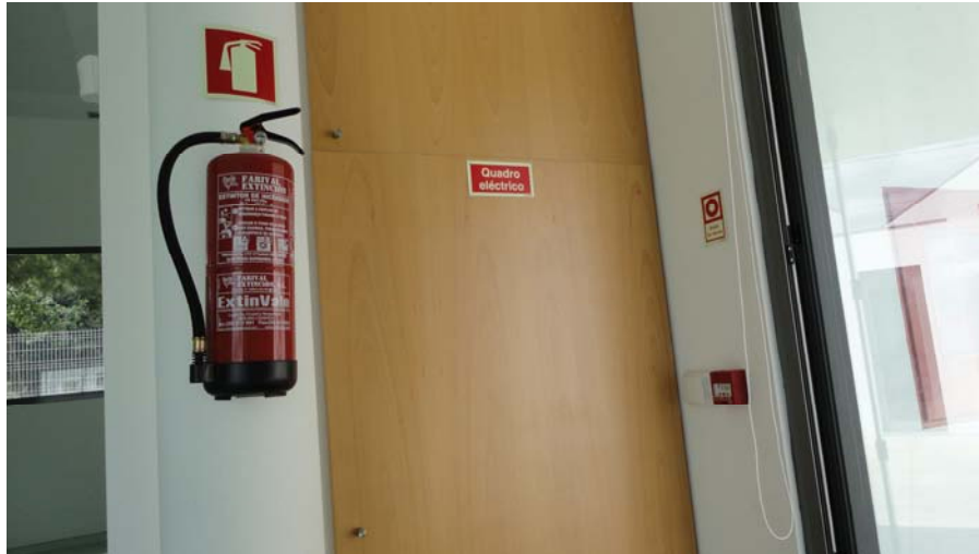
Fig. 5.33 – Extintor no corpo C
