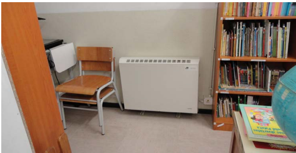
Fig. 5.14 – Sistema de aquecimento eléctrico
