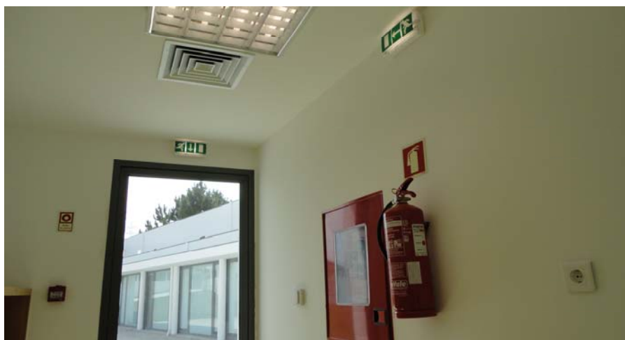
Fig. 5.32 – Extintor no corpo B
