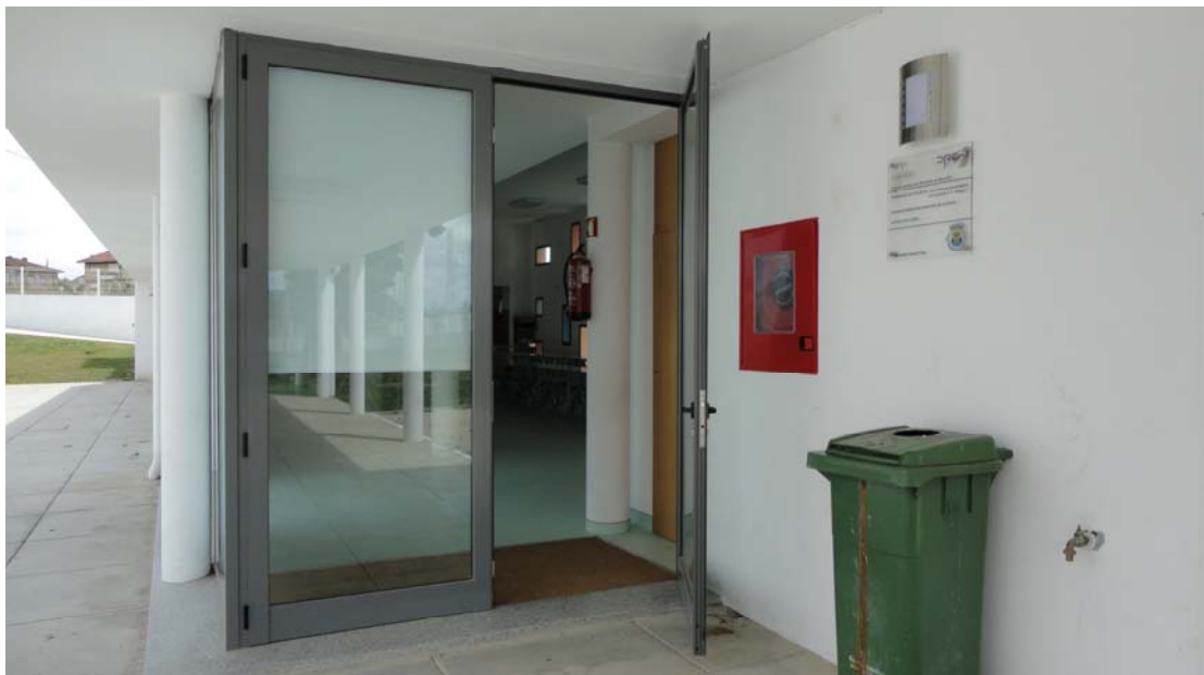
Fig. 5.29 – Extintor e rede de incêndio armada tipo carretel
