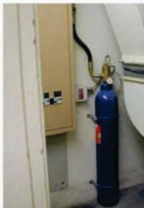
Fig 2.27 - Instalação fixa para protecção local de quadro eléctrico recorrendo a um extintor de pequena dimensão [8]
