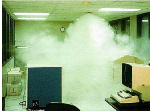
Fig. 2.25 - Imagem de um sistema de protecção fixo de halon, em actuação [8]
