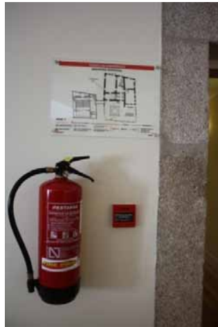
Fig 4.23 – Extintor ABC e Botoneira de alarme do 1º piso (Sala de Leitura/Espaço Internet)
