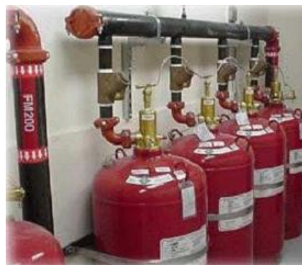
Fig 2.26 - Bateria de cilindros de FM200 numa instalação fixa de protecção contra incêndio [8]
