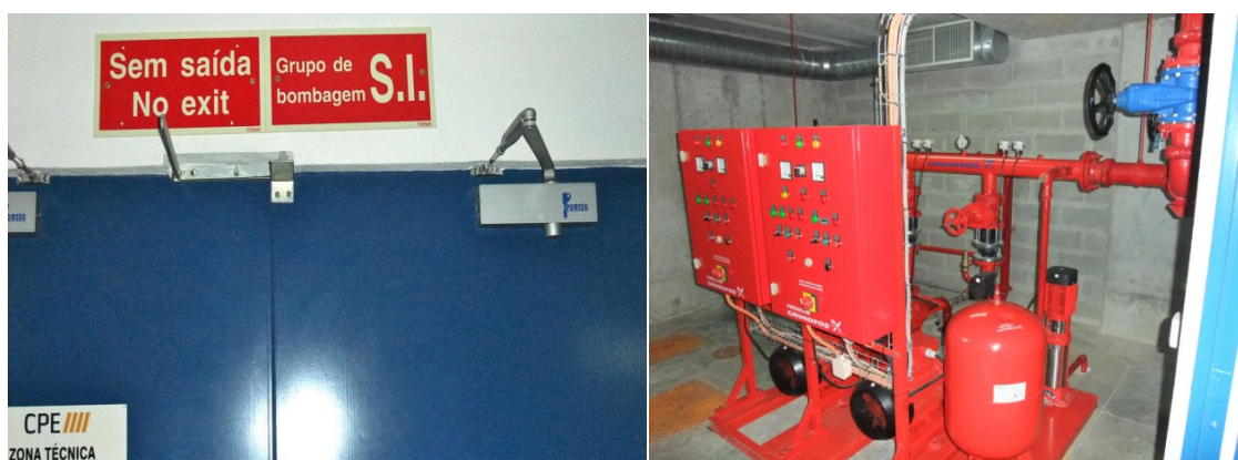
Fig.40 – Acesso ao grupo de bombagem
