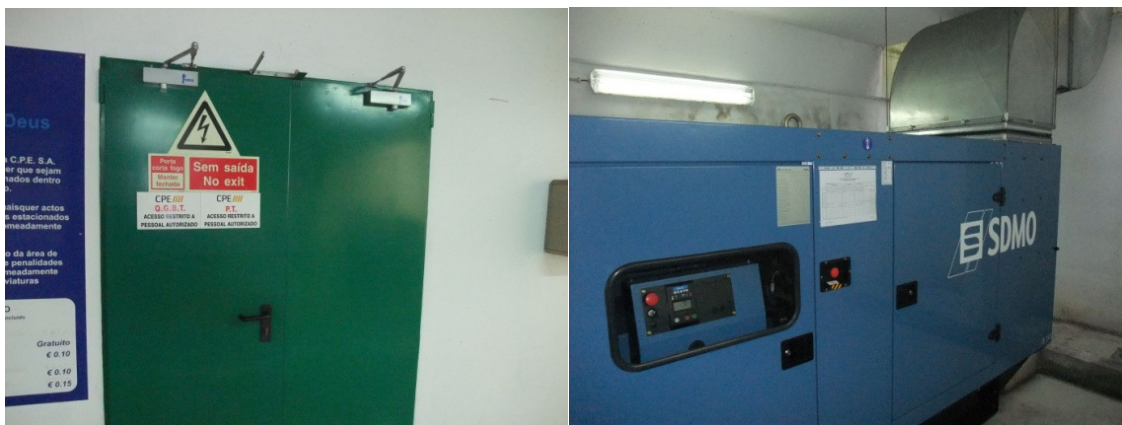
Fig.39 – Acesso a zona técnica e transformador
