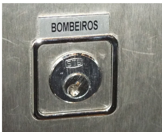
Fig.41 – Interruptor para serviço exclusivo de bombeiros
