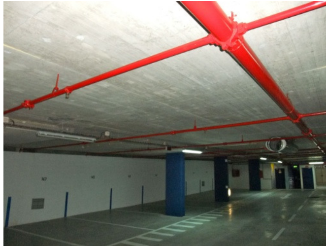
Fig.44 – Rede de sprinklers
