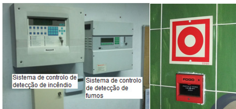
Fig.42 – Central de controlo dos sistemas de detecção, botão de pressão para alarme manual
