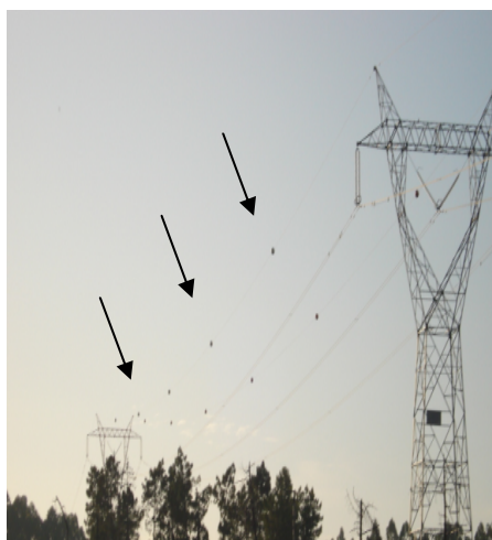
Figura 5.18 – Dispositivos de balizagem aérea:
