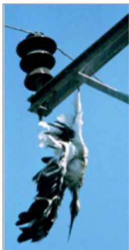
Figura 5.7 - Tipo de apoios e cabos condutores neste caso com uma ave electrocutada [31];
