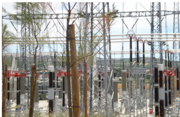
Figura 6.1 – Exemplo de uma subestação em Portugal;
