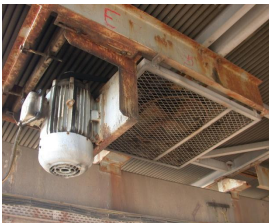
Figura 3.57. Corrosão uniforme no chassis
