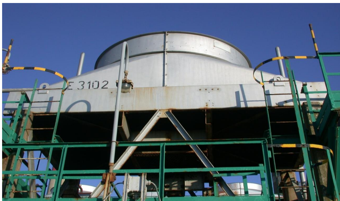
Figura 3.4. Aero-Arrefecedor da fábrica de combustíveis – aspiração induzida
