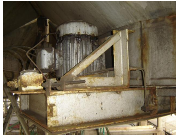
Figura 3.60. Suporte do motor eléctrico da unidade 1200.
