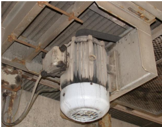
Figura 3.59. Suporte do motor eléctrico da unidade 3000.
