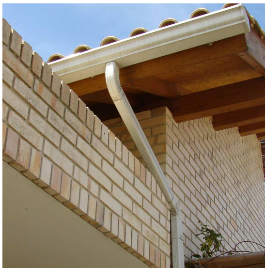
Figura 4.20: Pormenor das calhas de captação [84].
