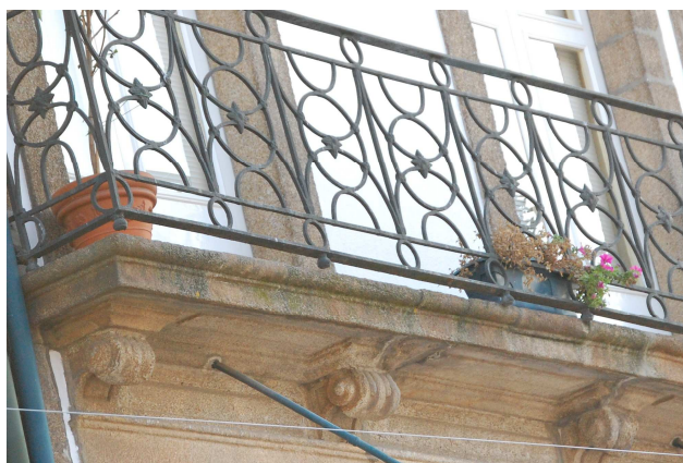
Figura 2.12 – Cachorro na parte inferior da laje da varanda. Gradeamento em ferro. (foto da autora)
