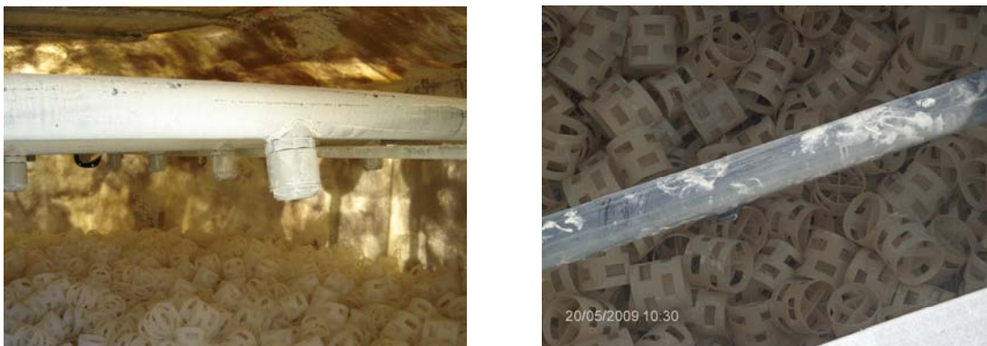
Figura 4.7: Suporte dos chuveiros antes (esquerda) e após (direita) limpeza.
