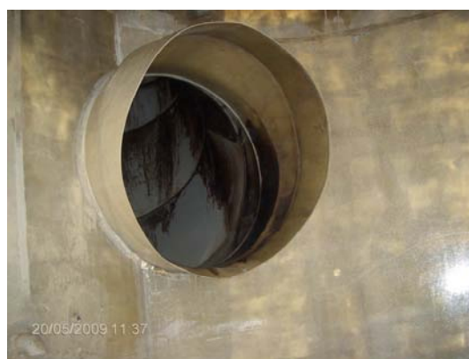
Figura 4.9: Tubagem por onde entra o ar na torre nº 2, alcalina/oxidante.
