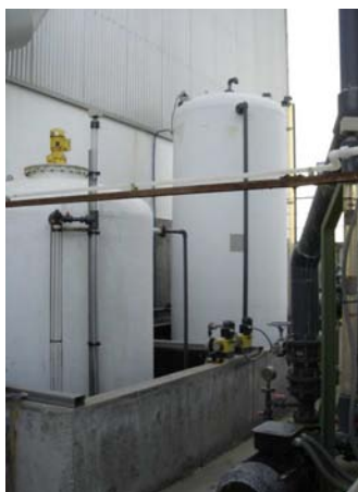
Figura 1.1.3: Tanques de armazenamento de NaOH (esquerda) e NaOCl (direita).
