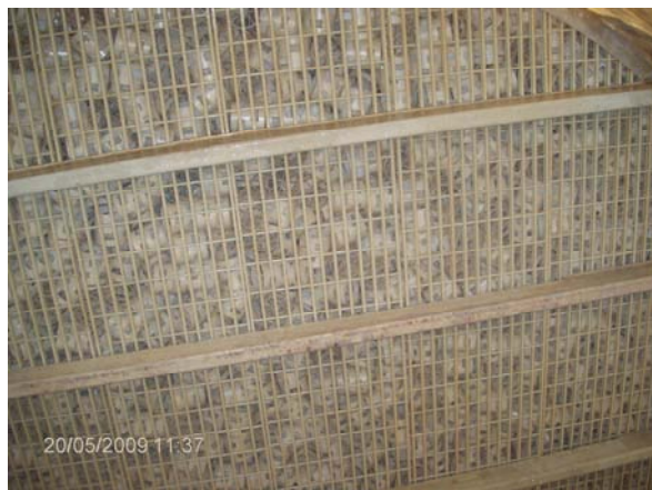
Figura 4.10: Suporte dos anéis de contacto na torre nº 2.
