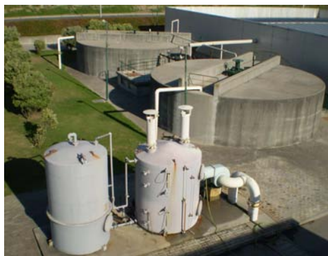
Figura 1.2.1: Colunas de adsorção em filtros de carvão activado.
