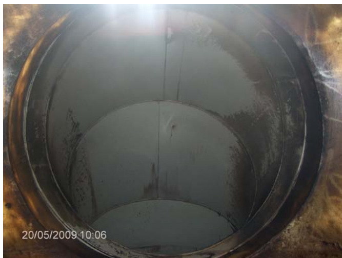
Figura 4.3: Tubagem por onde segue o ar da torre nº1.
