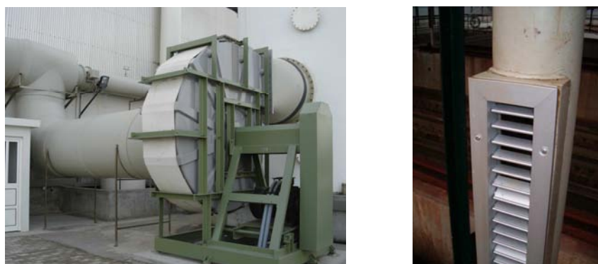
Figura 1.1.2: Ventilador das torres de desodorização química (esquerda) e grades de aspiração (direita).
