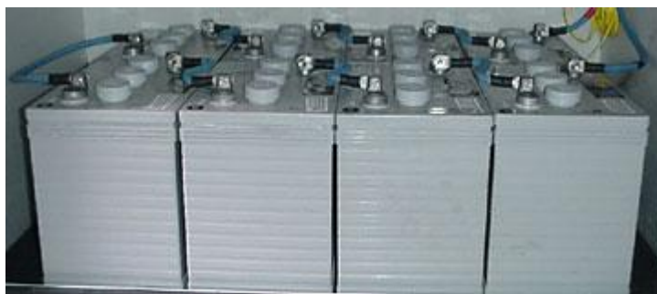
Figura 2.8 - Banco de baterias numa aplicação solar [1]
