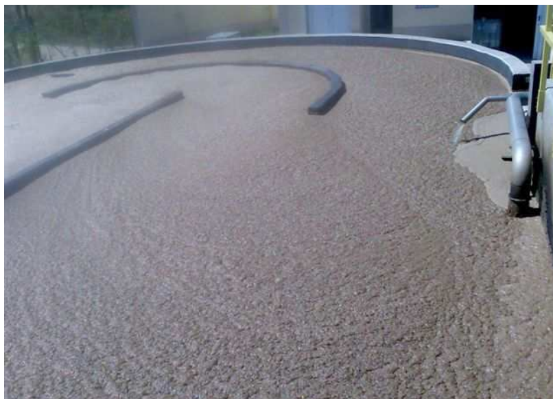
Fig.3.12 – Reactor biológico da ETAR de Cambres após uma descarga industrial.
