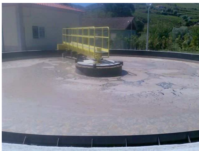
Fig.3.14 – Decantador secundário após descarga industrial.
