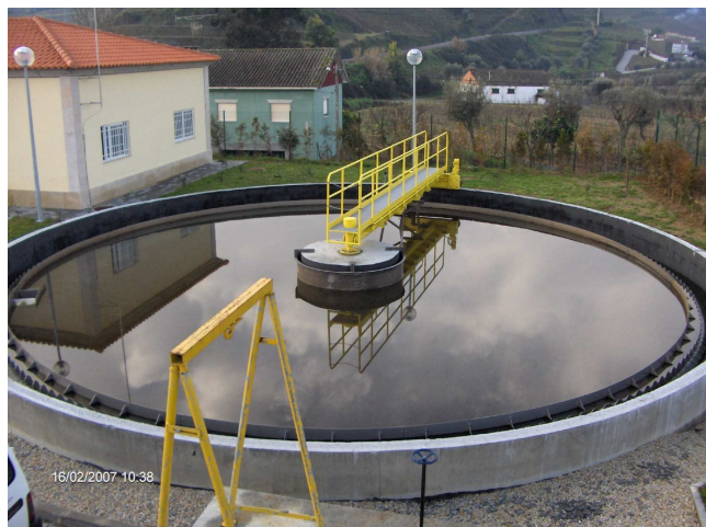
Fig.3.13 – Decantador secundário em funcionamento regular.
