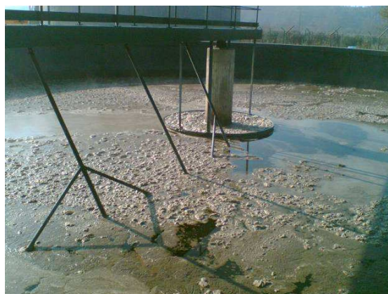
Fig.6.13 – Decantador secundário após descarga .
