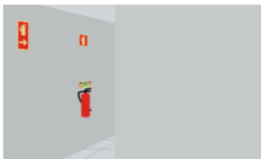
Fig.3.14 – Correcta sinalização dos equipamentos de luta contra incêndio [25].
