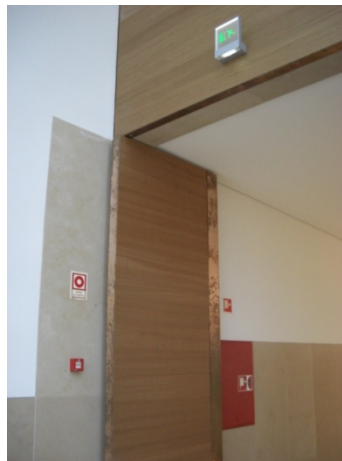
Fig.3.30 – Sinalização de segurança da Igreja da Santíssima Trindade.
