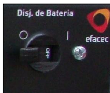
Figura 4.10 - Símbolo de abertura e fecho do disjuntor de bateria do equipamento.
