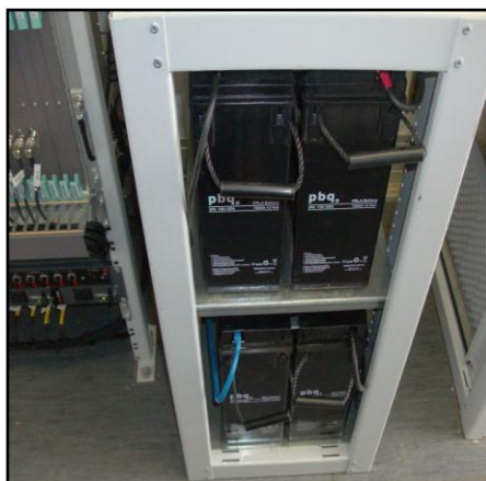
Figura 4.22 - Armário de baterias de 19'' adjacente ao equipamento, exemplo local de instalação.
