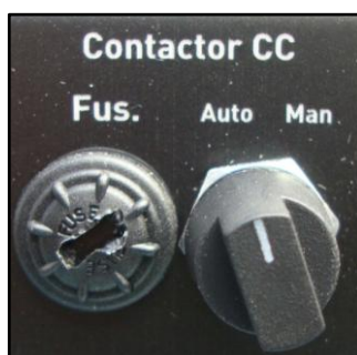
Figura 4.6 - Fusível de protecção do circuito do contactor de fim de descarga das baterias.
