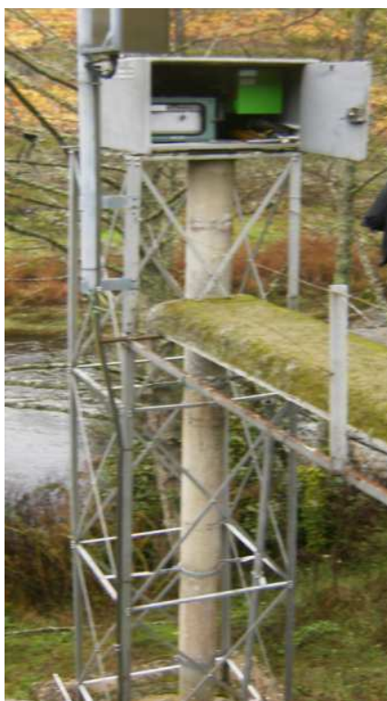
Figura 2.4 - Estação hidrométrica de Ermida, rio Corgo (fotografia no dia 12 de Novembro de 2009, durante uma campanha de medições de caudal)
