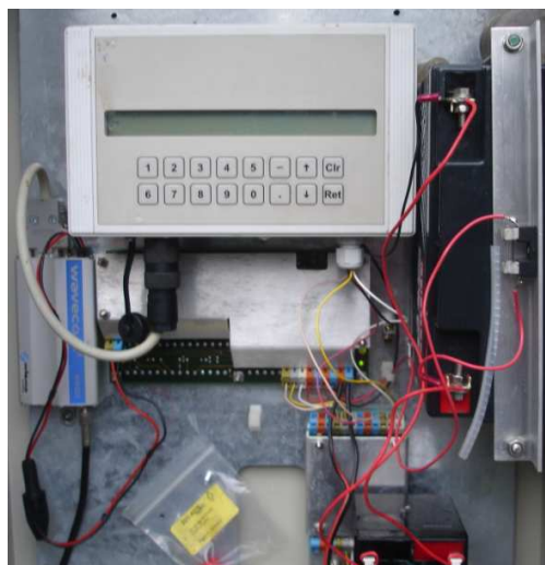
Figura 2.12 - Sistema de telemetria, existente na estação hidrométrica da Fábrica da Matrena, no rio Nabão, (fotografia tirada no dia 17 de Dezembro de 2009, durante uma campanha de medições de caudal)
