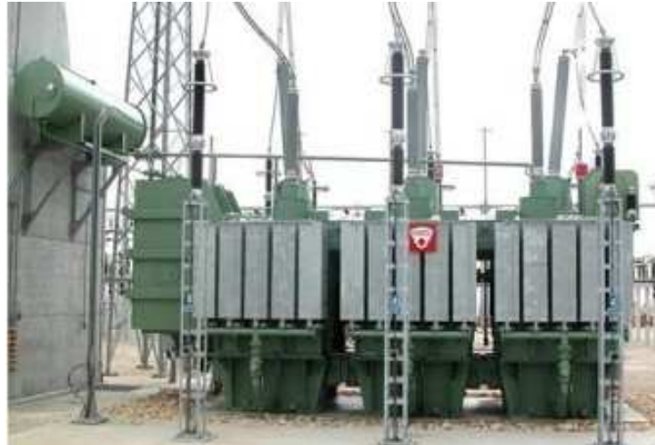
Figura 4 - Transformador em funcionamento
