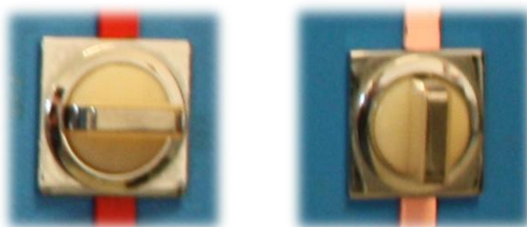
Figura 8 - Botão de disjuntor aberto (esquerda), fechado (direita)
