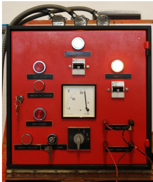
Figura 12 - Painel principal onde se desliga o alarme de erro
