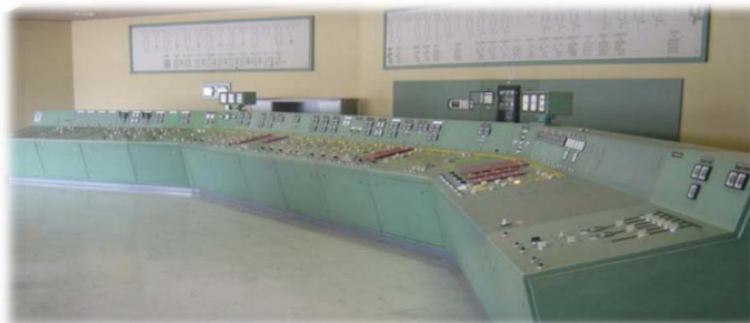
Figura 2 - Sala de comando de uma subestação
