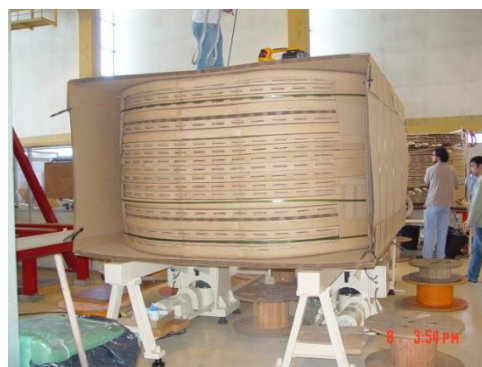
Figura 4 – Grupo de um transformador SHELL.
