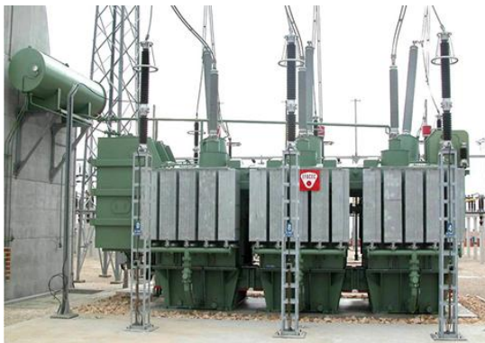
Figura 9 – Transformador SHELL em serviço.
