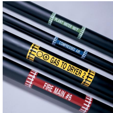
Figura 21 – Identificação de tubos diversos.
