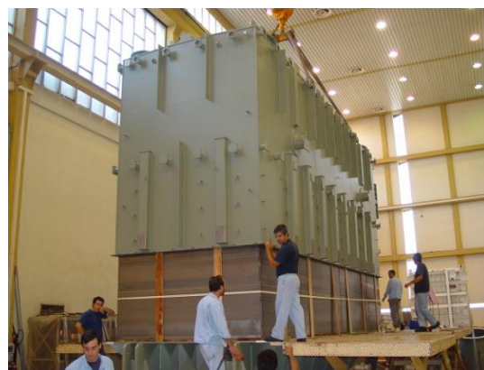
Figura 8 – Montagem da cuba superior de um transformador SHELL.
