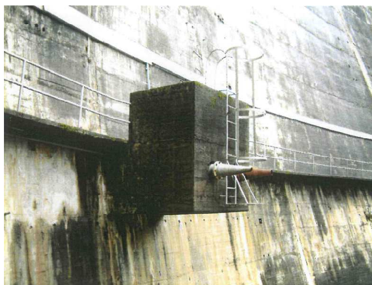
Fig. 5.44: Barragem de Vilarinho das Furnas. Dispositivo de caudal ambiental. Fonte: EDP – Gestão da Produção de Energia, S.A. (2006c)
