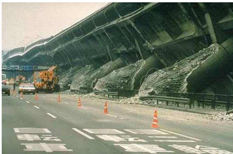
Figura 2.2 – Ponte Hanshin após o sismo Kobe (Delgado, 2000)
