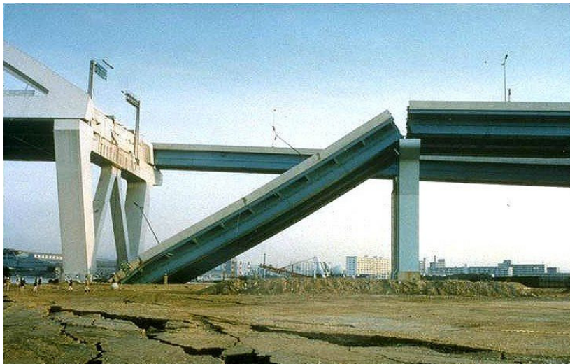
Figura 2.1 – Queda do tabuleiro da ponte Nishinomiya-ko (Delgado, 2000)
