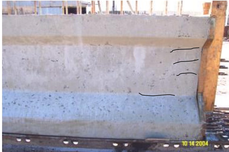
Fig. 2.6 Fendilhação de extremidade em viga I pré-esforçada (Dhonde, Mo e Hsu, 2005)
