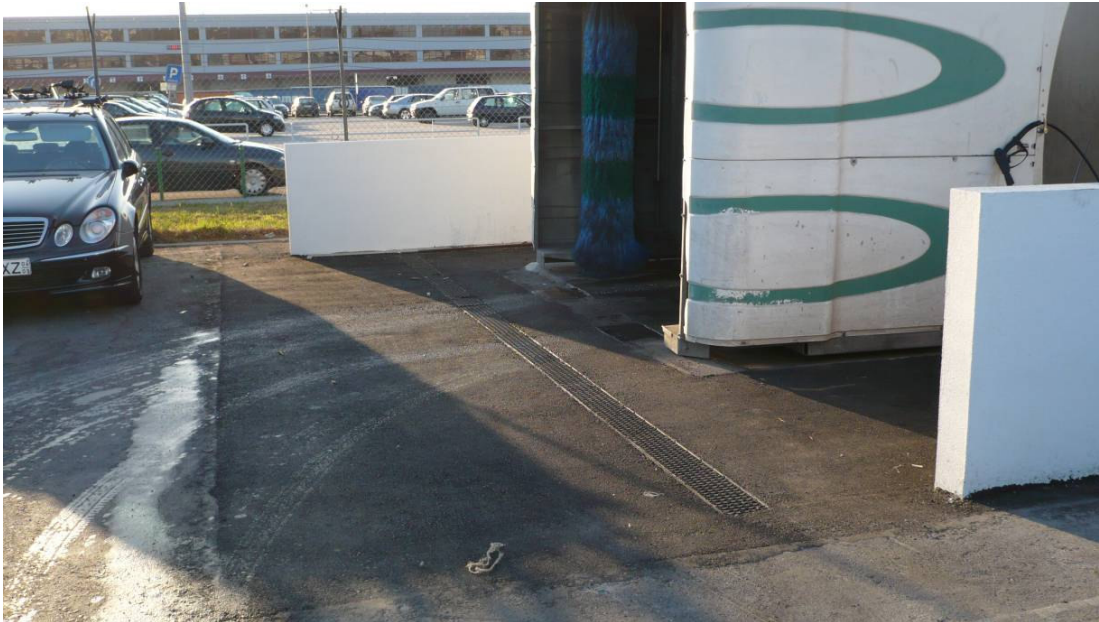
Fotografia 5 - Grelha do canaleta.
