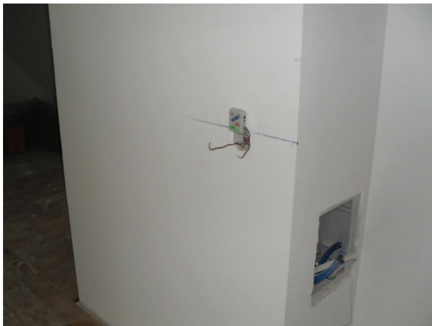
Fig. 84 – Sensor colocado no corredor do Piso 1
