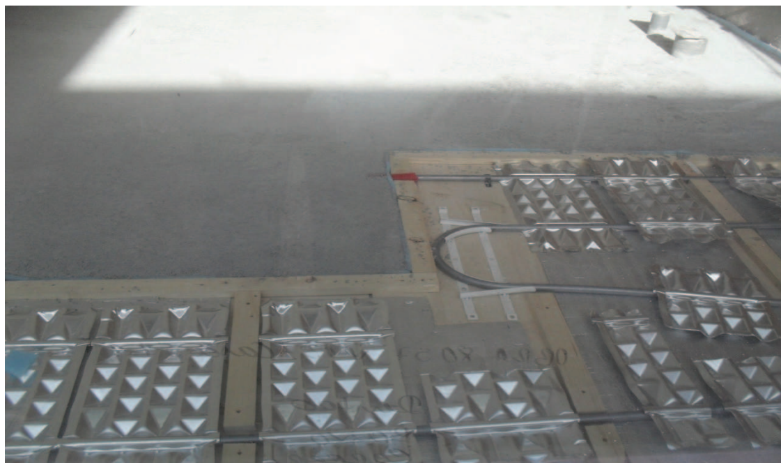
Fig. 56 – Pavimento da cozinha – Pavimento húmido
