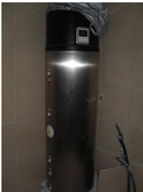
Fig. 43 – Termoacumulador de águas quentes sanitárias
