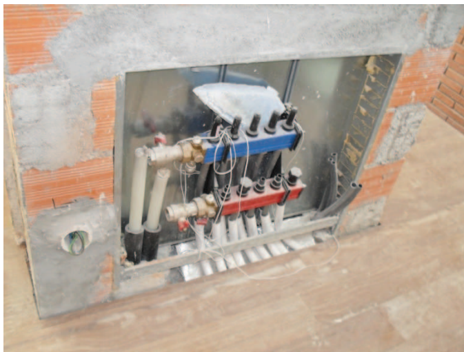
Fig. 49 – Colector do pavimento radiante
