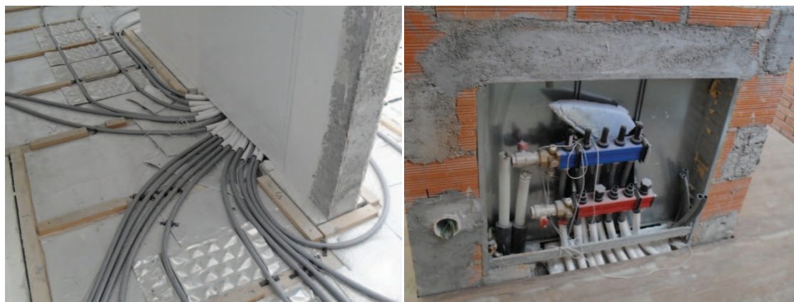
Fig. 55 – Colectores do pavimento radiante
