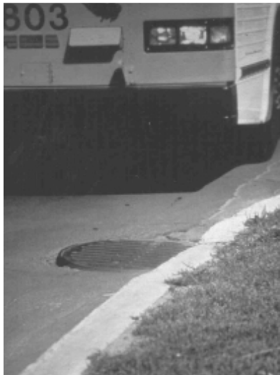
Fig 8.1 – camião a passar na caixa de visita não nivelada
