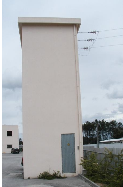
Figura 2.18 - Posto de transformação de cabina alta
