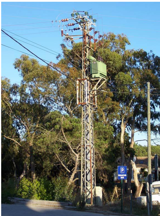
Figura 2.13- Posto de transformação aéreo
