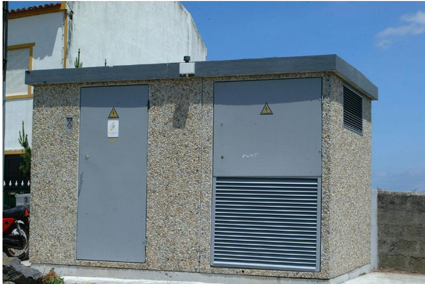
Figura 2.16 - Posto de transformação de cabina baixa
