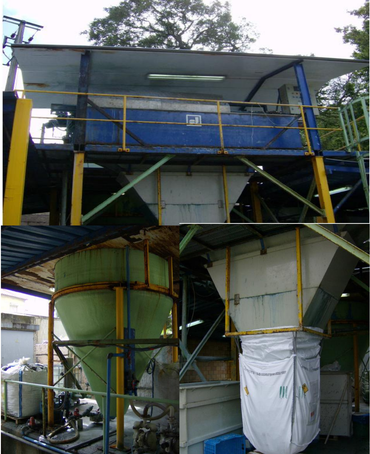
Figura 5 – Pormenores da ETAR da DOURECA – Filtro de Lamas
