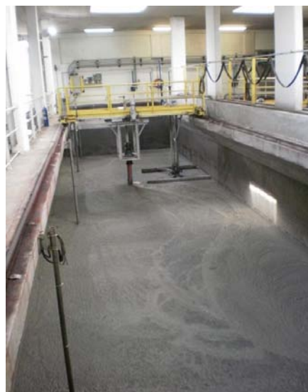
Figura 6 - Tratamento Primário – ETAR do Freixo
