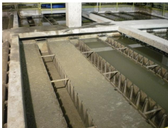
Figura 2 - Tratamento Primário – ETAR de Sobreiras
