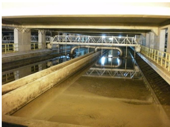
Figura 3 - Decantador secundário – ETAR de Sobreiras
