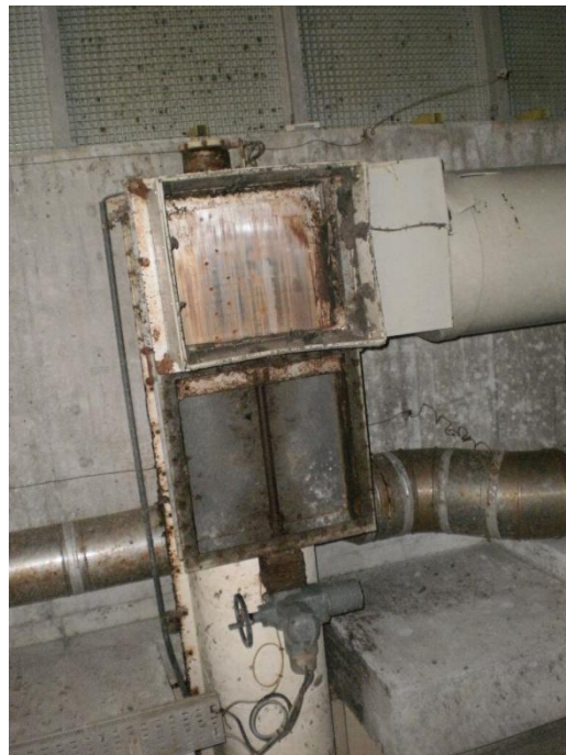
Figura 4 - Local de descarga de lamas mistas – ETAR de Sobreiras
