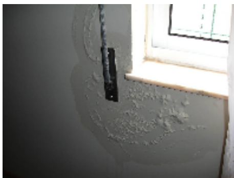
Figura 3: Registo fotográfico de uma anomalia num vão devido à infiltração de humidade num ponto singular de uma habitação
