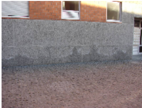
Figura 2: Registo fotográfico de uma anomalia na parede exterior devido à humidade ascensional
