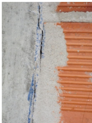
Figura 176 – Esmagamento das juntas verticais no interface de ligação do tijolo com o betão.
