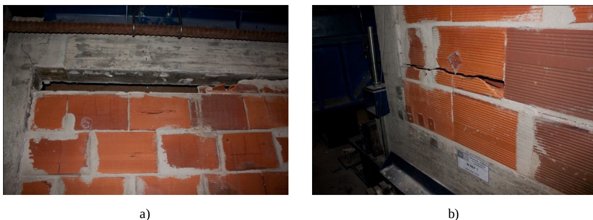
Figura 184 – Resultado final do ensaio: a) colapso total das unidades canto superior direito; b) fendilhação na base esquerda a cerca de 0.25 m da viga de betão armado
