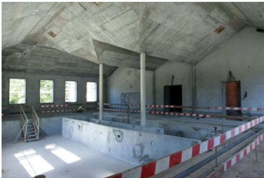
Figura 19 – Piscina interior do novo spa termal. [62]
