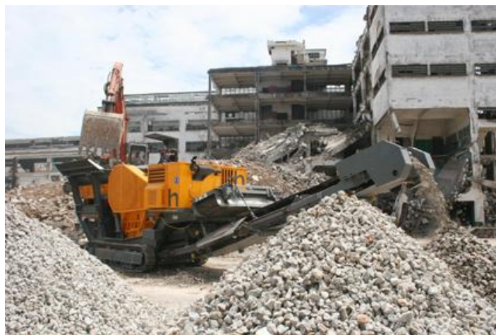
Fig.2.22. – Resíduos provenientes da construção.
