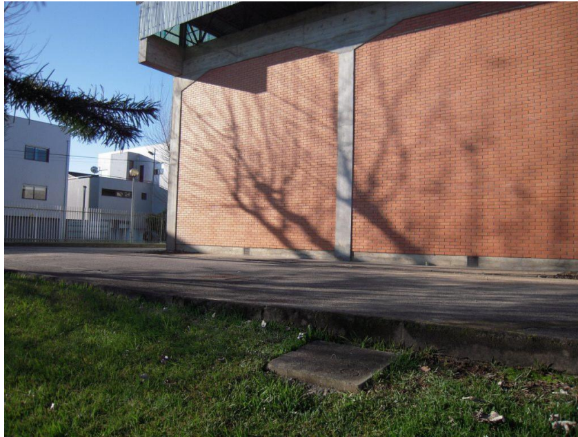
Fig.4.25. – Poço de água nas imediações do pavilhão desportivo
