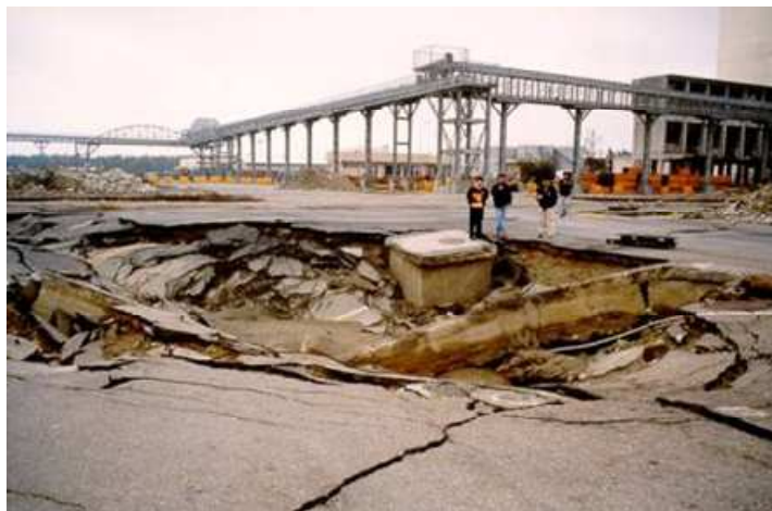
Figura 2. 4 – Evidente sinal de liquefacção resultante do sismo de Chi Chi (1999).
