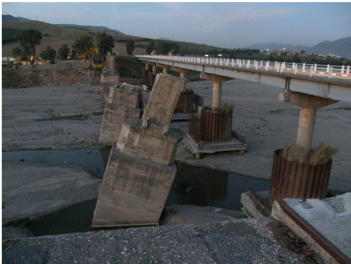
Figura 1. 2 – Ponte arruinada por liquefação dos solos arenosos de fundação dos pilares em 2003 e nova estrutura de substituição (entre Boumerdès e Tizi-Ouzou, foto em Junho de 2009).
