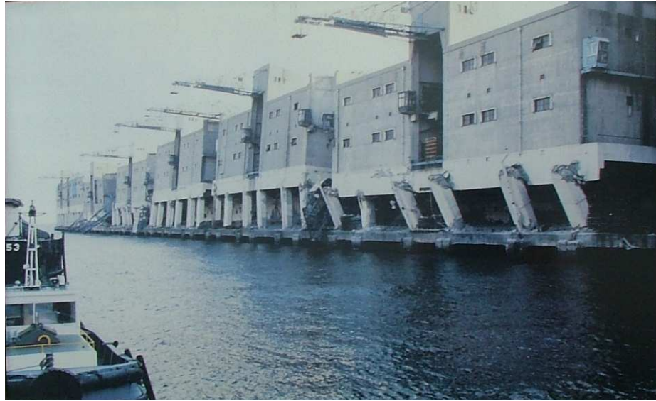
Figura 2. 3 – Estruturas de armazéns portuários arruinados pela cedência de muros-cais provocado por liquefacção (Kobe, 1995).
