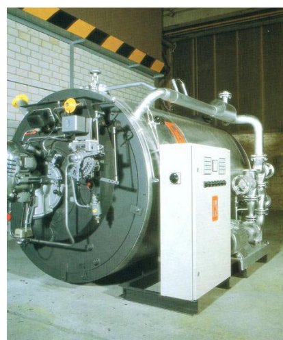
Figura 3.11 – Caldeira horizontal com potência de 5,8 MW, dotada com pré aquecimento do ar de admissão.
