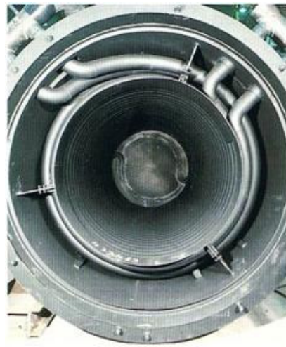
Figura 3.9 – Vista do interior de uma caldeira, onde é possível visualizar a serpentina permutadora de calor, onde circula o fluido térmico.
