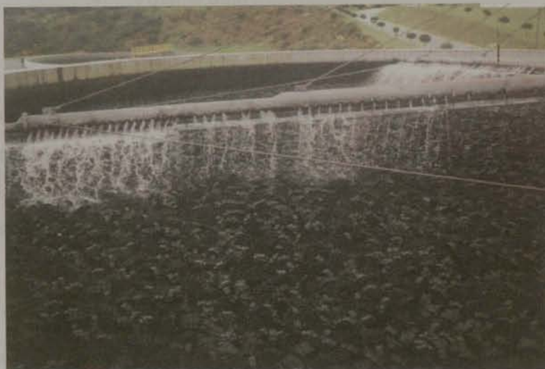
Figura 10 – Enchimento plástico dos leitos percoladores.
