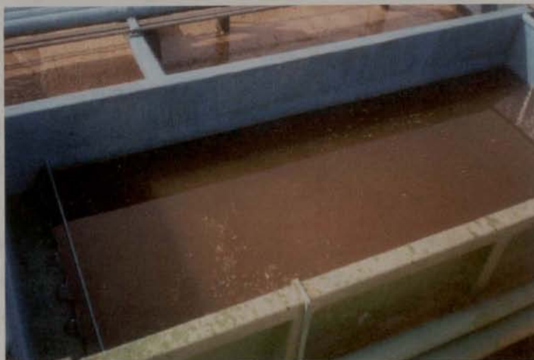
Figura 20 – Decantador secundário da ETAR de Areias de Vilar.
