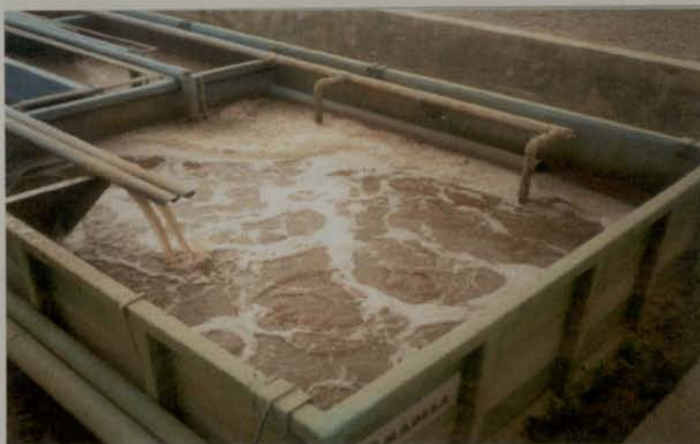
Figura 19 – Tanque de arejamento da ETAR de Areias de Vilar.
