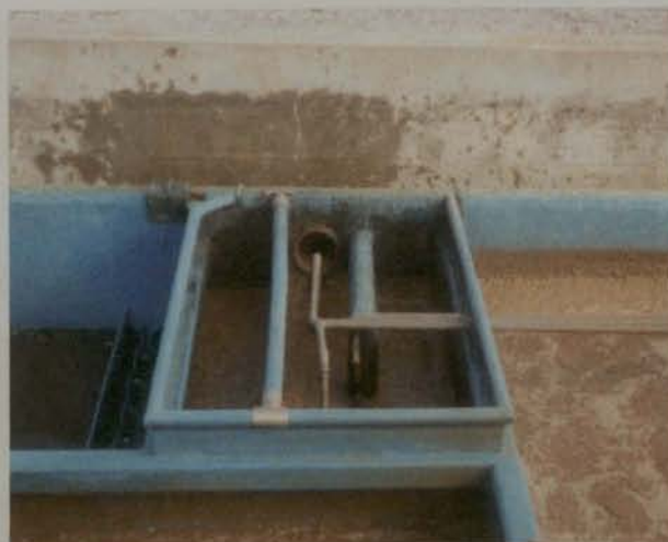
Figura 17 – Desarenador e desengordurador da ETAR de Areias de Vilar.
