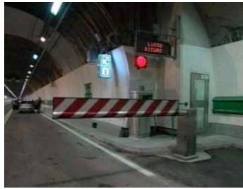
Fig. 5.9 – Barreira, semáforo e sinal de mensagem variável [51]
