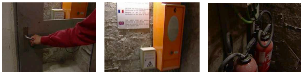
Fig. 5.5 – Posto de emergência [47]
