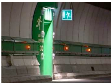
Fig. 5.2 – Saída de emergência [51]
