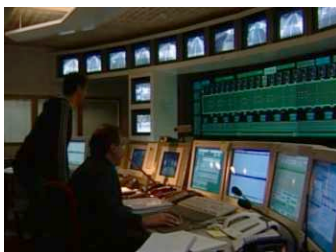
Fig. 5.8 - Centro de comando e controlo [51]
