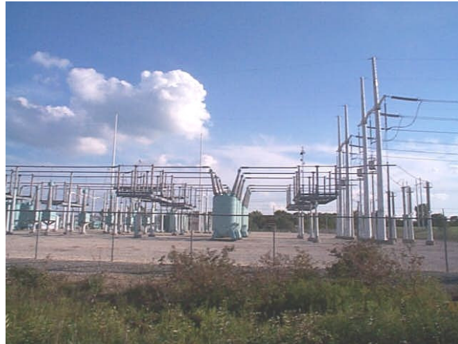
Figura 4 – Subestação de energia.
